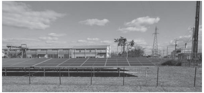
サンエーが施工した野立ての太陽光発電所
