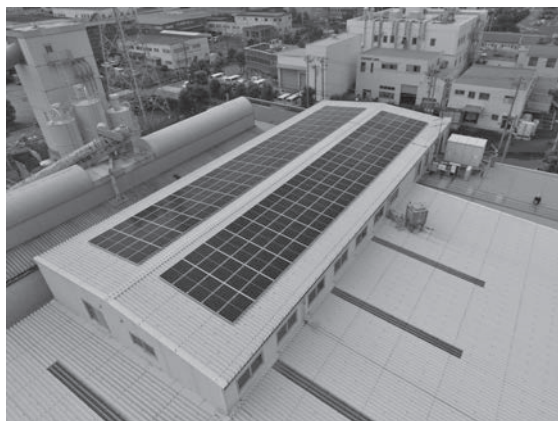
サンエーが施工した自家消費用の太陽光発電設備
