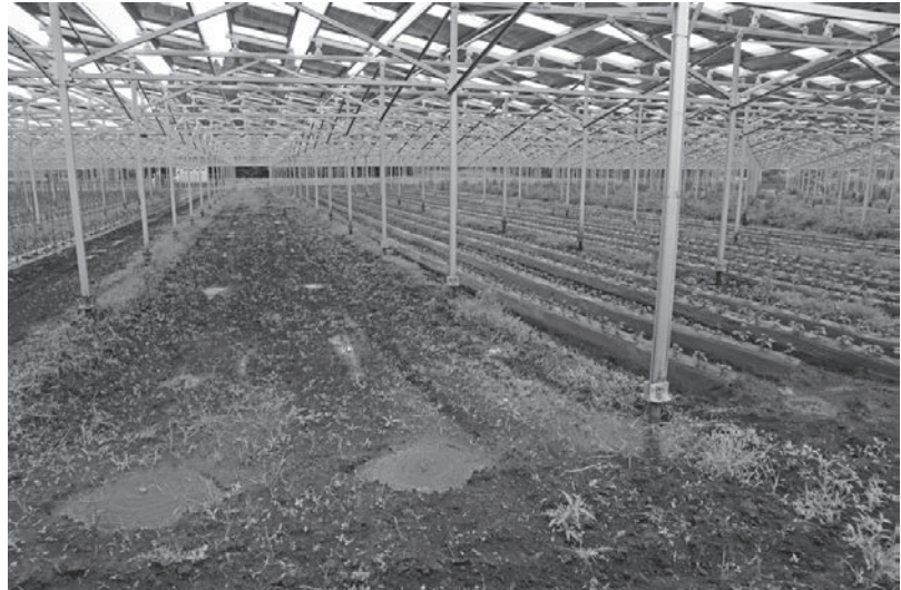
ソーラーシェアリング設備
