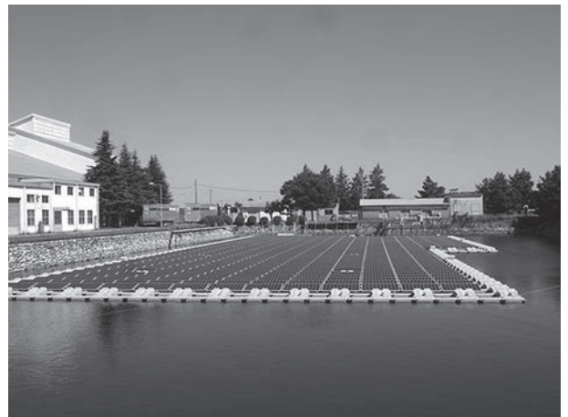
黒部の事業所で設置された太陽光発電設備
