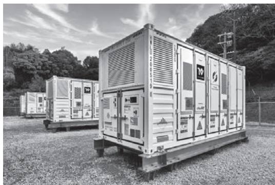
熊本県荒尾市に設置した系統用蓄電池
