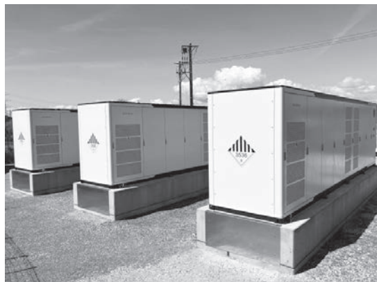
御前崎市で運転開始した蓄電所 (東急パワーサプライより写真提供)
