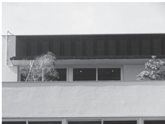
モノクロームの壁面設置型太陽光パネル
